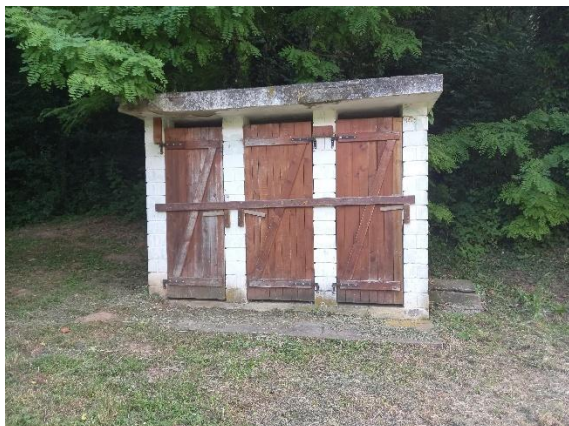
5. fénykép Régi, leromlott állapotú mosdó
