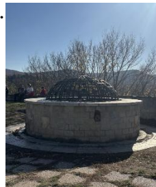
10. kép Felújítandó kút
