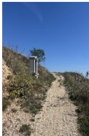
31. kép A természetes erózió által veszélyessé válható útszakasz (Forrás: saját kép)
