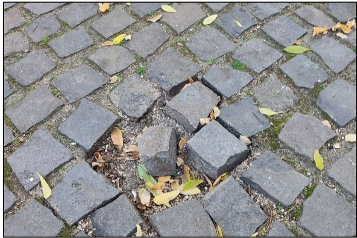
7. ábra: A kockakő burkolat hibája a Hunyadi téren (Forrás: Saját fénykép, 2024)
