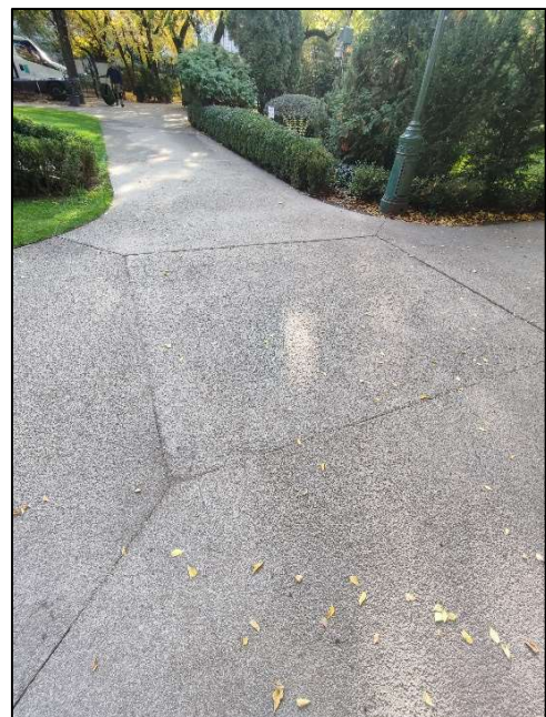
16. ábra: Beton dilatáció a Honvéd téren (Forrás: Saját fénykép, 2024)
