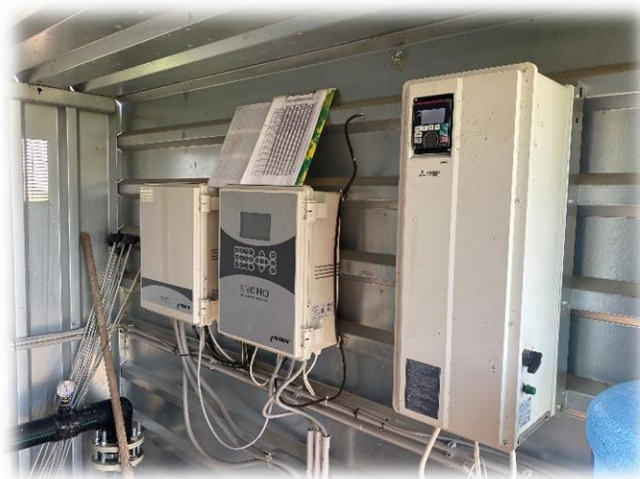
37. ábra Netafim vezérlő a tárkányi pumpaházban (fotó: szerző)
