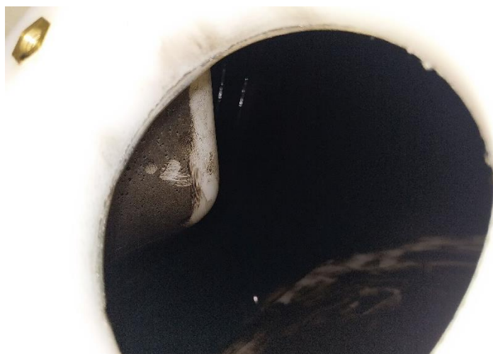
16. ábra Korommal szennyezett üzemanyag tank belső felülete
