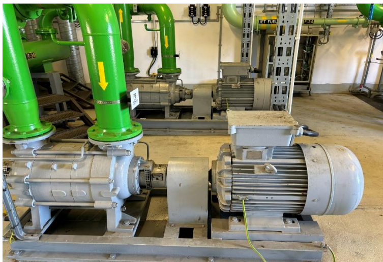
1. számú kép: Szivattyú (szerző képe)
