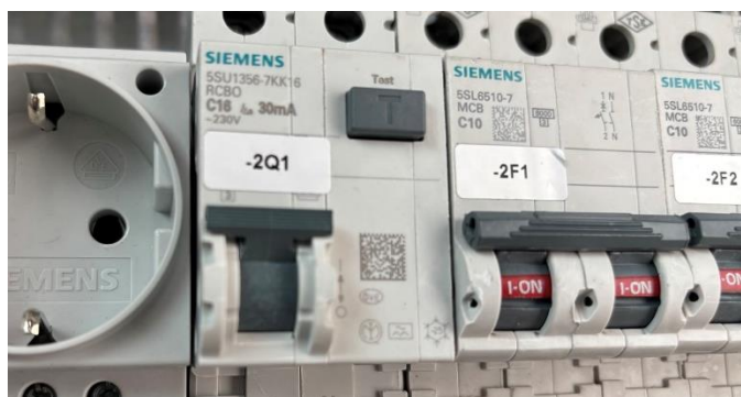
10. ábra Beépített életvédelmi relé [saját készítés]
