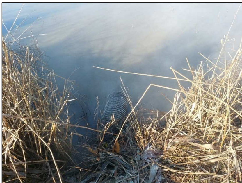
4. kép A termálfürdő szürkevizének kifolyócsöve 2024.01.21. Saját kép
