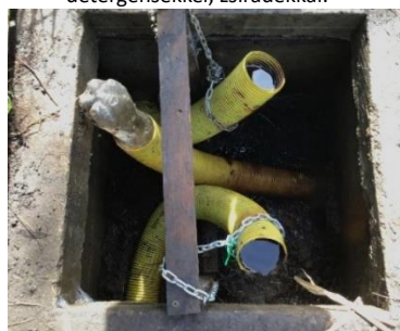
Ellenőrző és mintavételi akna a két szűrőmező két vízszintszabályozójával. A középső cső a nem megvalósult kerti tó tisztított szűrkevíz csatlakozása lett volna.
