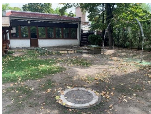
A képek 2024.09. 27-én készültek. A szűrőmező a tornaterem épülete előtt, a fakorlát által elhatárolt területen helyezkedik el. Az épület tetejéről összegyűjtött csapadékvizet a szürkevízzel együtt gyűjtik. (Forrás: saját kép)
