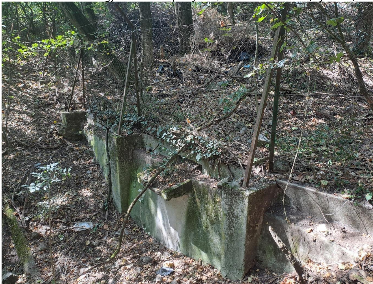
14. Melléklet: Vízmű tárgy a kert keleti pontjában, külterületi rész felé (saját fotó)
