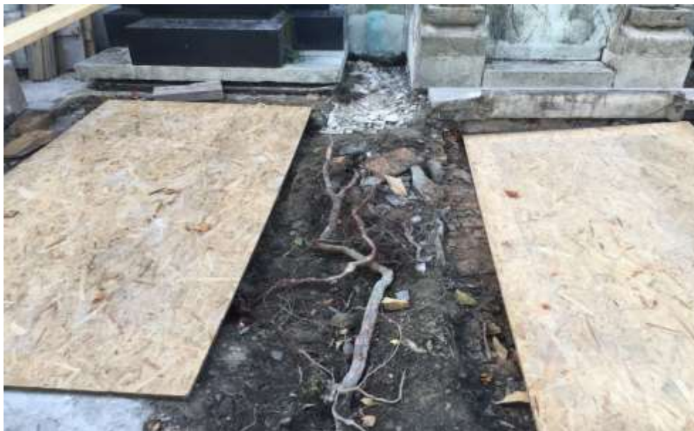
20. ábra: Az Árkádsor felújításakor eltávolított magoncok gyökerei (Forrás: Saját fotó 2018)
