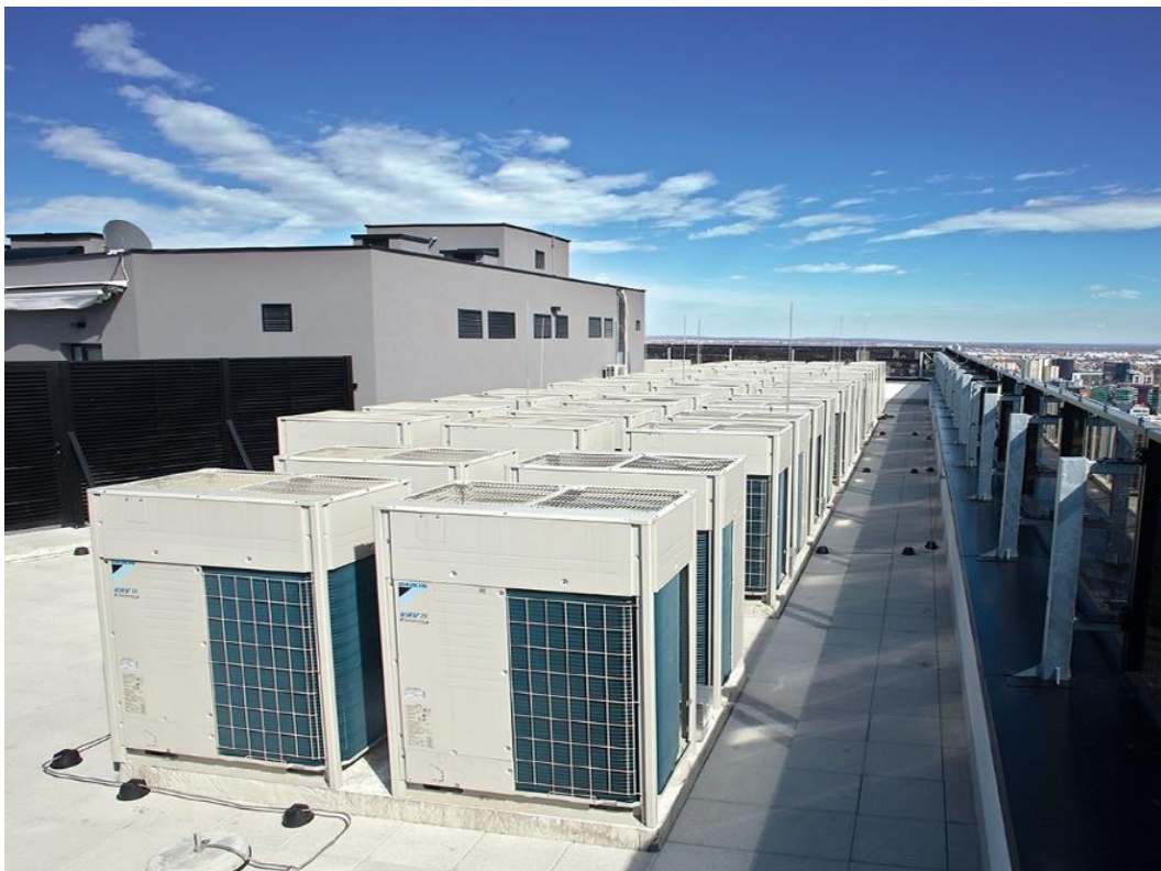
5. ábra: tetőre telepített VRF rendszer (Forrás: https://www.daikinafrica.com )
