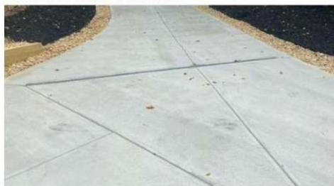
Dilatált beton burkolat
