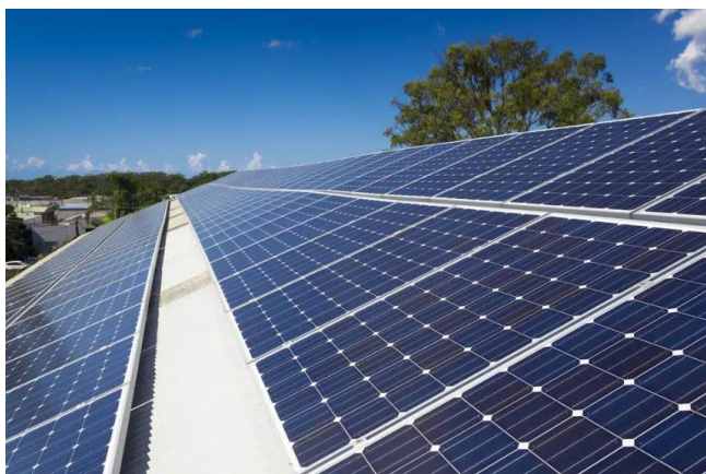
2. ábra: Polikristályos napelem panelek egy tetőfelületen. (forrás: https://www.energymatters.com.au/monocrystalline-solar-panels )
