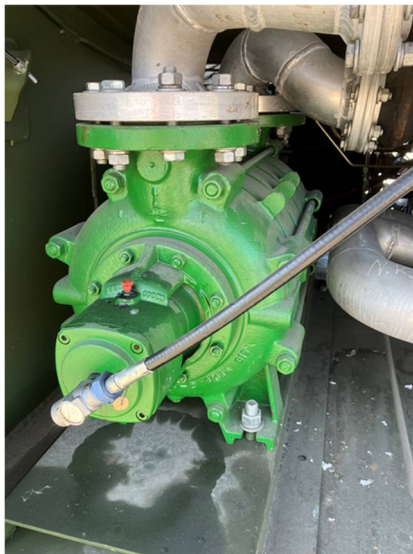
7. ábra Dickow HZS 1033 típusú szivattyú beépített állapotban a tartályfélépítőkoszi armatúraszekrényében, előtérben a hengergörgős csapágyház és a fordulatszámérő spirál (forrás: Saját felvétel)
