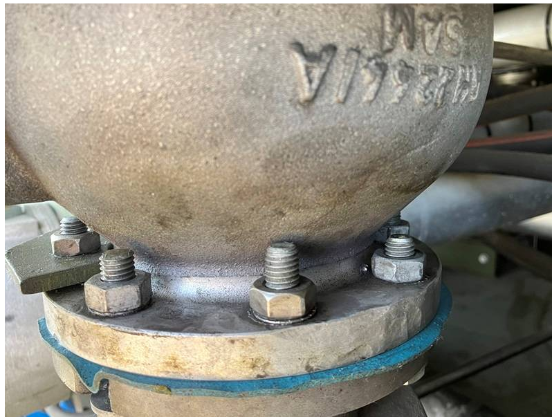
18. ábra Az automataszelep és a kémlelőüveg karimáit összefogó csavarkötések spontán fellazulása ellen gyenge a védelem, ami az üzemi rezgések hatására szivárgást idéz elő. A jobboldali hatlapú anyán több utánhúzás nyoma is felismerhető (forrás: Saját felvétel)
