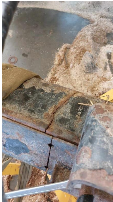
10. ábra: Repedések a JCB 418S rakodógép gémjén
