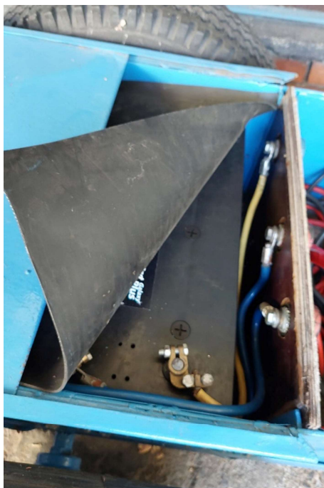
8. kép: Az akkumulátorok biztonságos, megfelelő fedése (Saját forrás)
