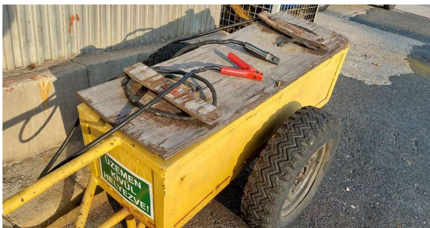
13. kép: Nem megfelelő fedőlap, jogosulatlan hozzáférés nincs megakadályozva (Saját forrás)
