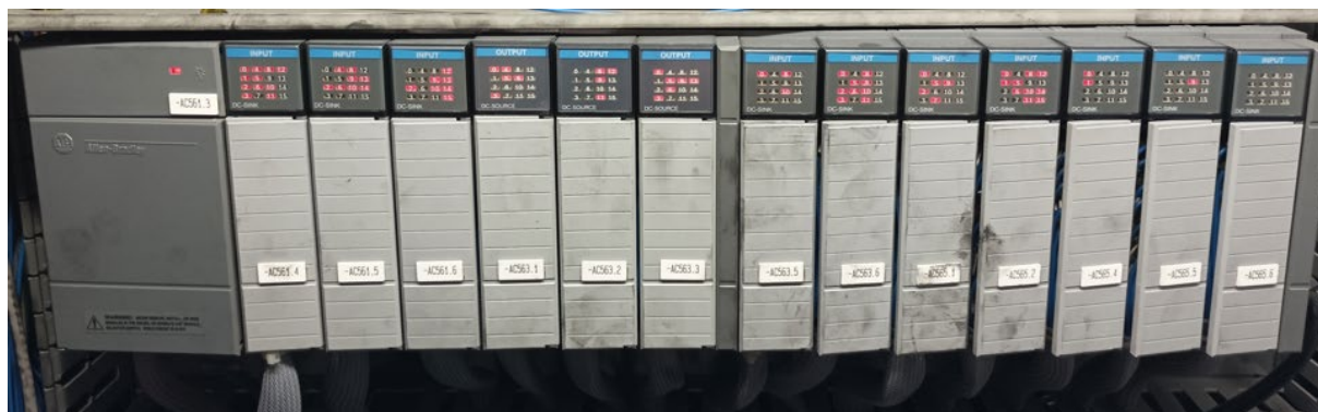
21. ábra: PLC családok - SLC500 (f), ControlLogix (k), CompactLogix (l)
