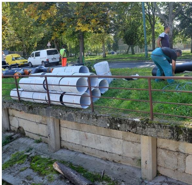
25. ábra Ajka, Torna-patak meder újítás (Fotót készítette: Györkös József)
