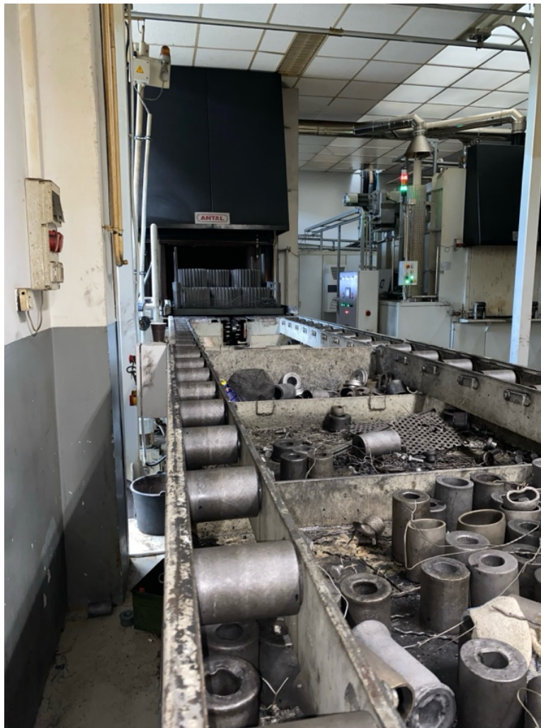
4.1. ábra Edzőkemence szállítószalagja
