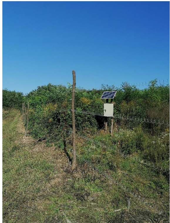
6. kép 6 soros villanypásztor, forrás: saját fotó
