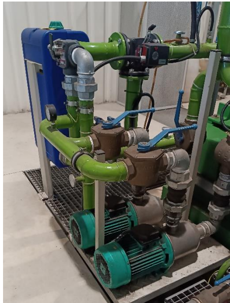
11. ábra: Fékpad hűtőköréhez csatlakozó szivattyúk
