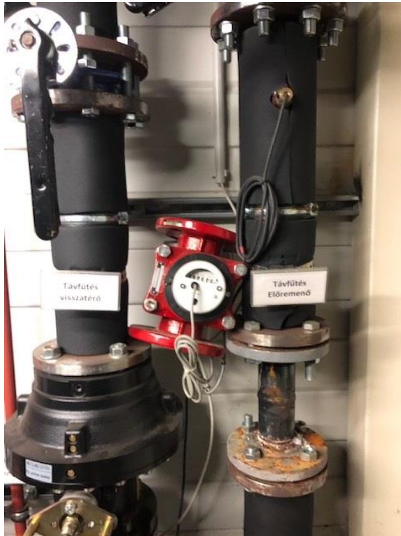
3. ábra Távfűtés előre menő meleg víz átfolyás mérő kiszertelt állapotában
