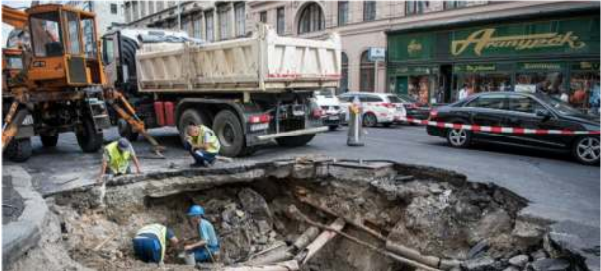
6. ábra Beszakadt úttest a Ferenciek terénél. (Forrás: SEBA szeminárium, 2019)
