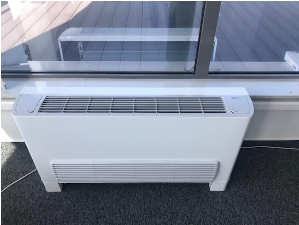
11. kép új fan coil berendezések
