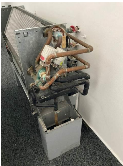
6. kép VAC típusú korrózió
