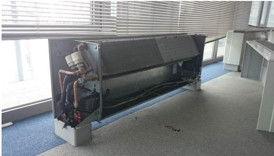
4. kép VAC típusú fan coil állapota
