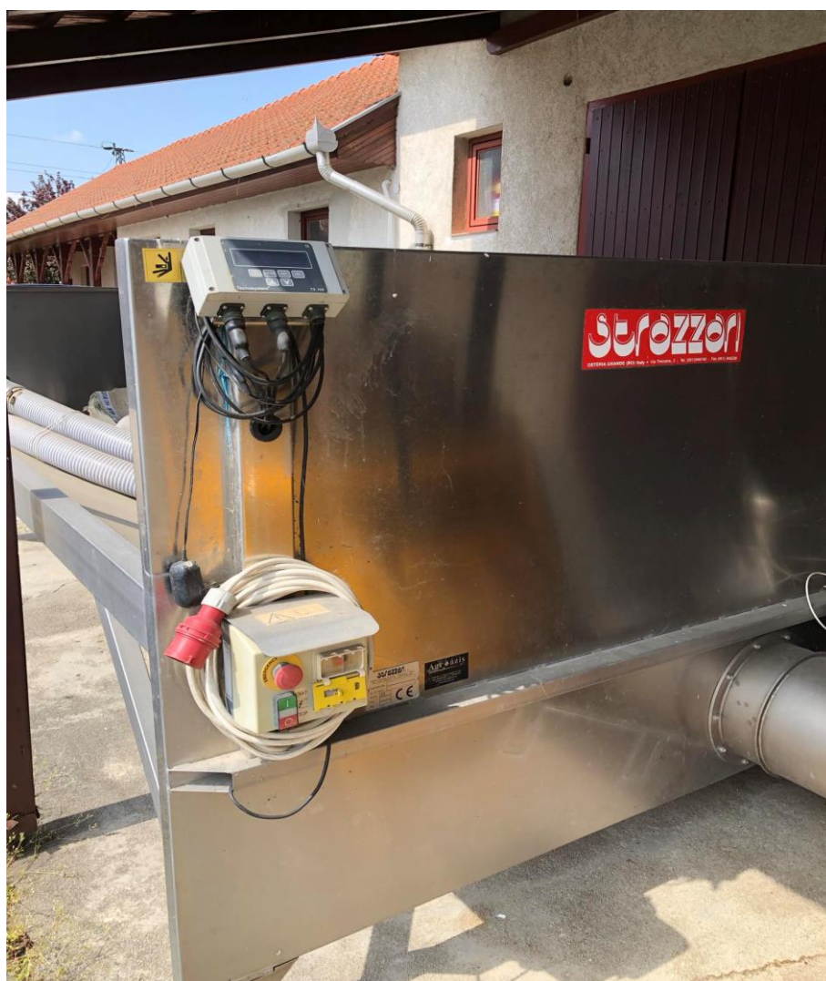
10. ábra: Beépített mérőcella (Saját forrás)
