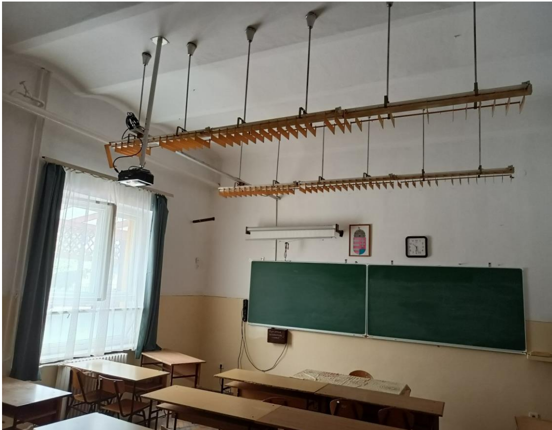
45. ábra. Egy osztályterem világítása felújítás előtt (saját fotó)
