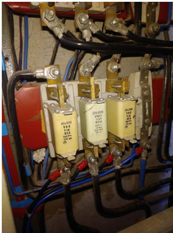
23. ábra. Az épület villamos fogadó szekrénye. (saját fotó)
