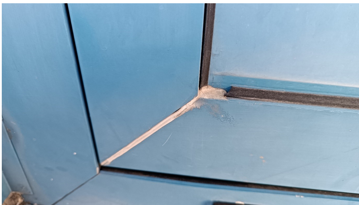
8. fénykép: Nyílászárók tömítés és illesztési dilatáció problémája (2) (Forrás: saját felvétel a Fornetti Kft. engedélyével)
