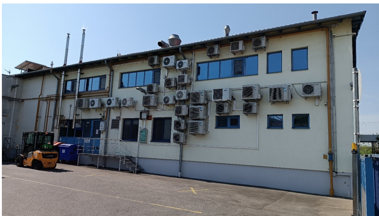
2. fénykép: A Fornetti Kft. irodaházának oldalsó része a split klímákkal (Forrás: saját felvétel a Fornetti Kft. engedélyével)
