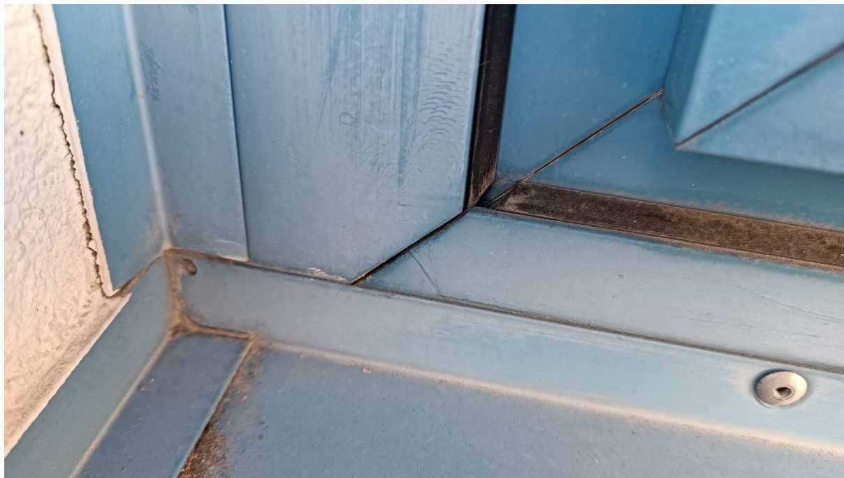
7. fénykép: Nyílászárók tömítés és illesztési dilatáció problémája (1) (Forrás: saját felvétel a Fornetti Kft. engedélyével)
