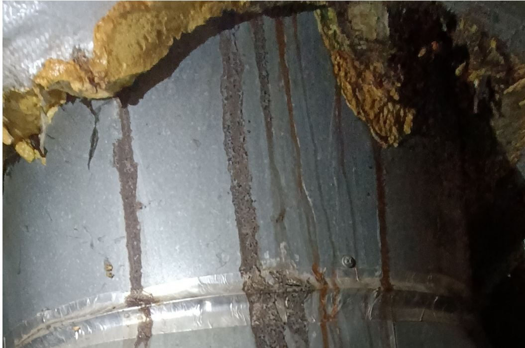
5. fénykép: Egy példa az irodaház légtechnikai tetőátvezetésének beázására (Forrás: saját felvétel a Fornetti Kft. engedélyével)
